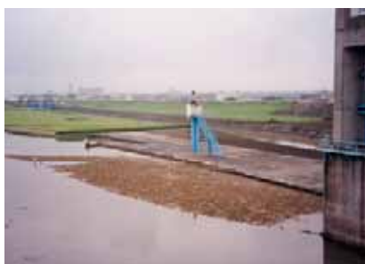
閘門前面に溜まった ゴミにより船の通航 ・魚道操作に支障
