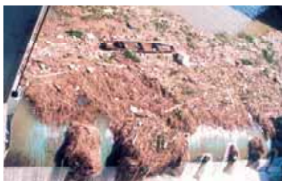
ゲートの開閉に支障
