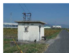
県営ポンプ(農業用水)
