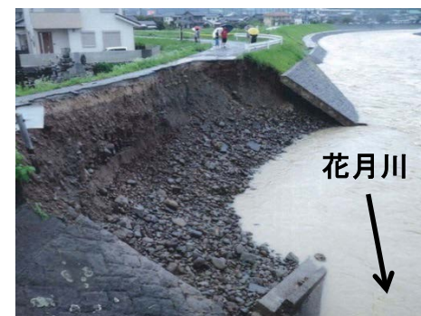
花月川右岸2k800付近堤防欠損(花月川)
