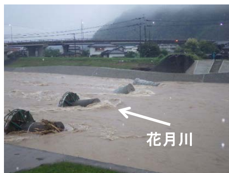
JR吹上橋梁流出(花月川)
