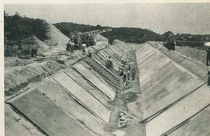
テスト工事全景(コンクリート面はビニール溶液を吹付け養生中)
