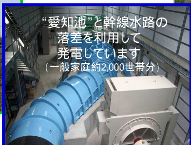
水(工業用水)を取水する施設です
