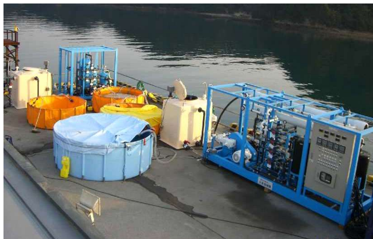
装置全景（1号機）
