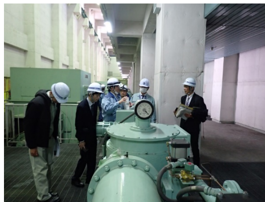
■弥富揚水機場ポンプ設備の視察の様子
