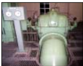
農業用水大型2号ポンプ
