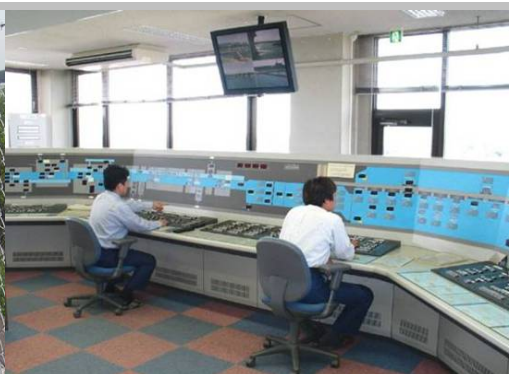
操作室での流況監視状況
