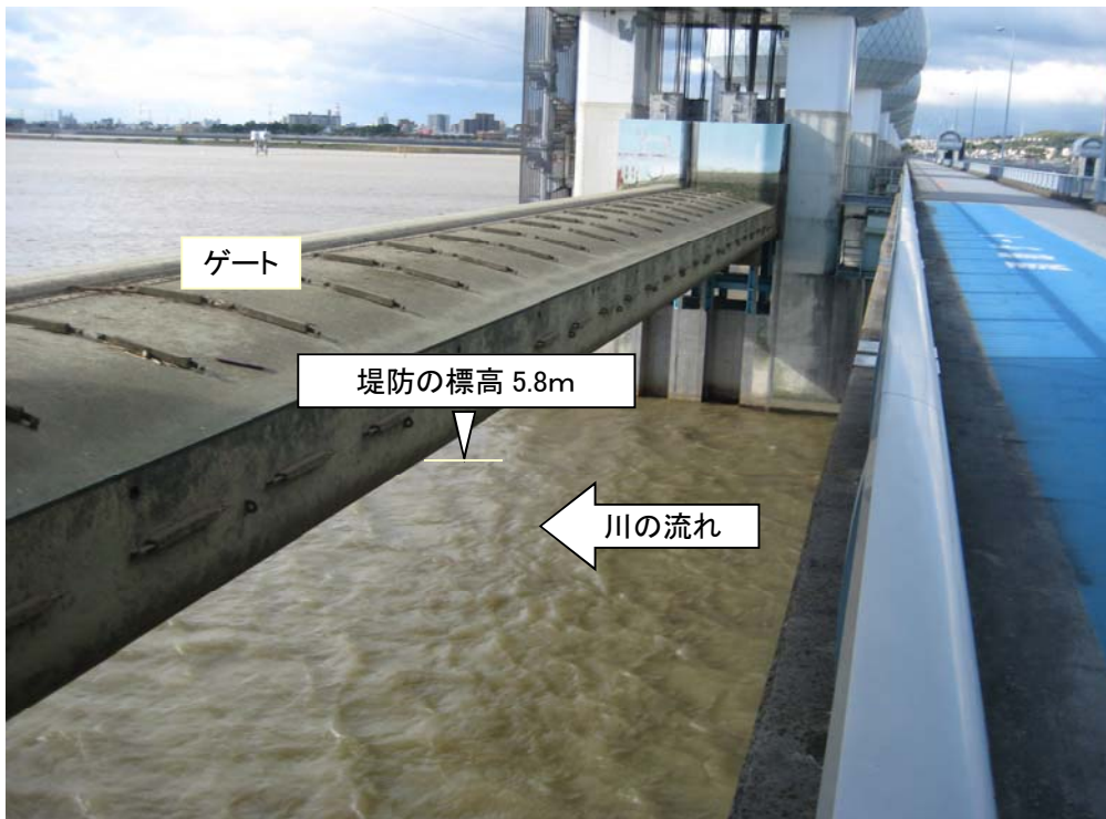
ゲート全開操作時の長良川河口堰（堤防より高い位置にゲートを引き上げ）
