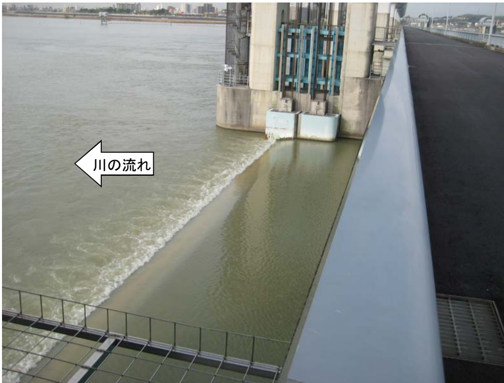
ゲート全開操作終了後の長良川河口堰(オーバーフロー操作に切り替え) 4月22日7時撮影
