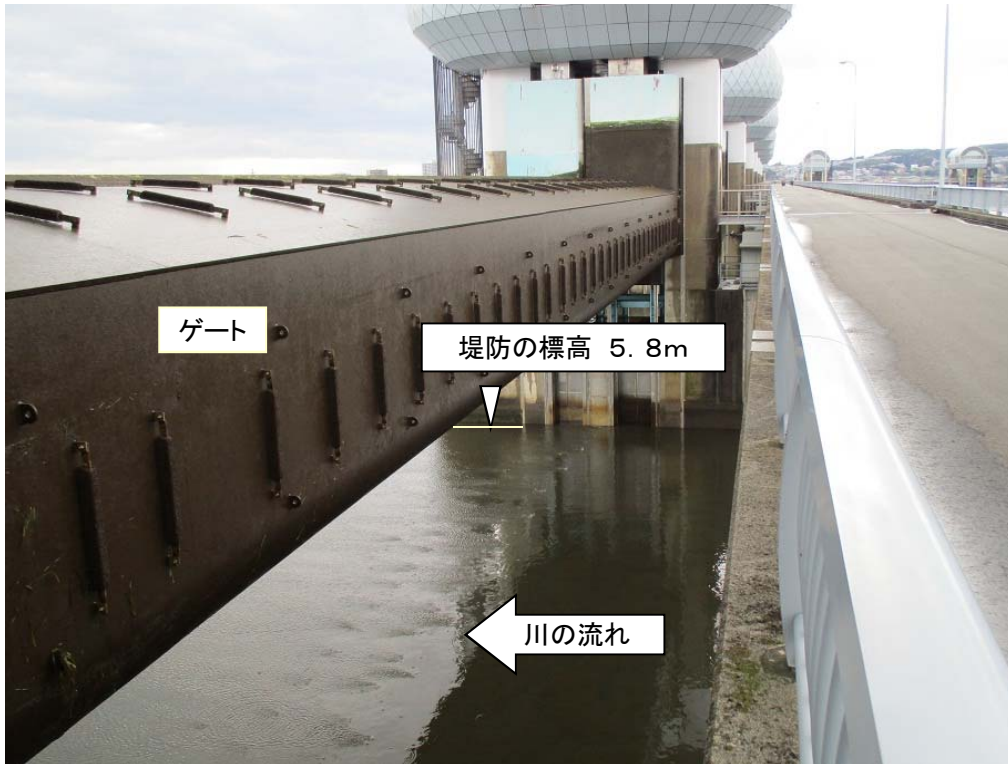
ゲート全開操作時の長良川河口堰（堤防より高い位置にゲートを引き上げ）
