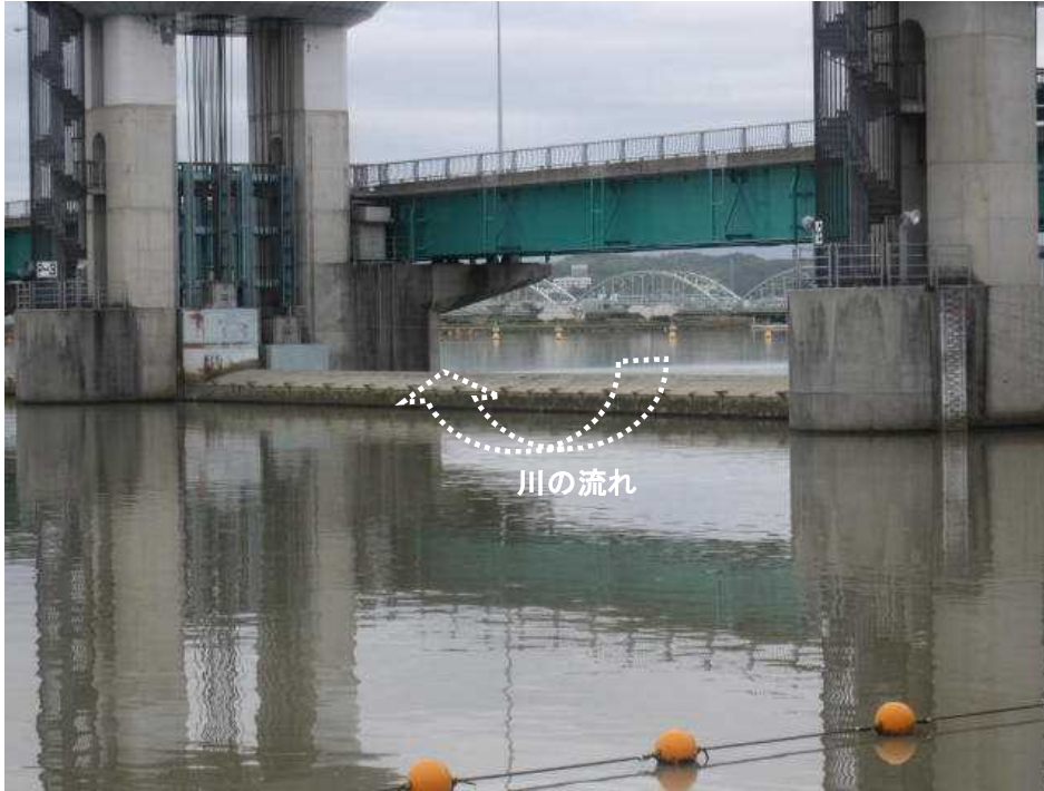
ゲート全開操作終了後の長良川河口堰（アンダーフロー操作に切り替え）
