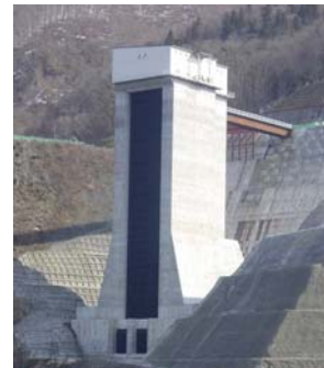
選択取水設備
