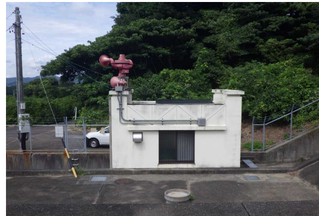
蒲郡調整池のサイレン警報設備
