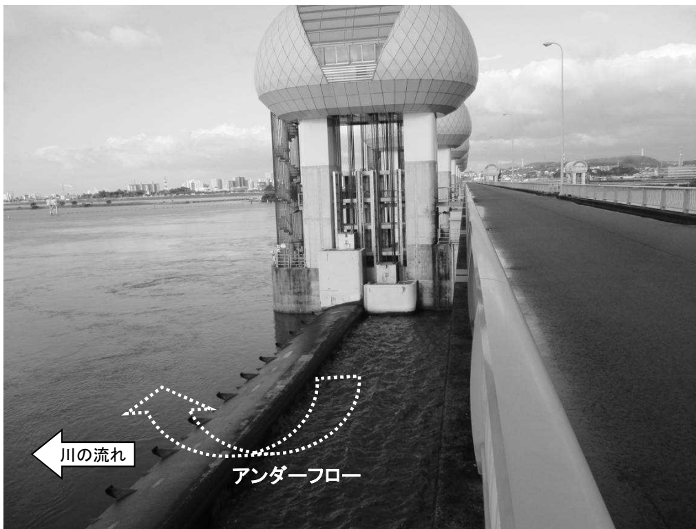
ゲート全開操作終了後の長良川河口堰 5月14日 6時撮影
