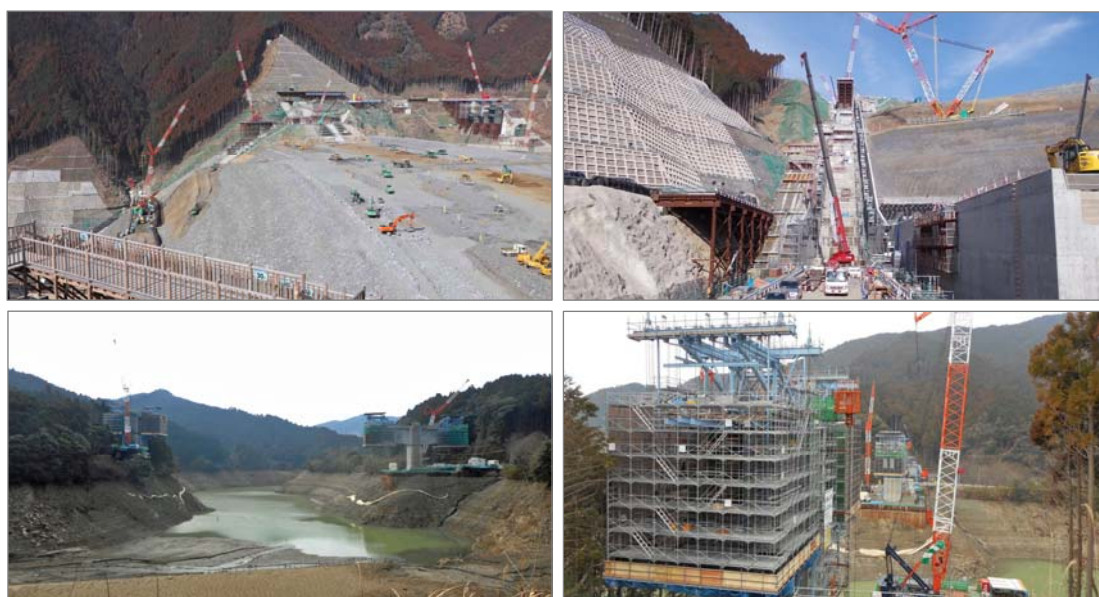
【写真上段】（左）ダムサイト左岸より （右）洪水吐き 【写真下段】（左）付替国道1号橋（上流から） （右）付替国道1号橋（左岸から）
