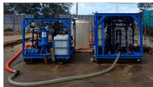
可搬式浄水装置2号機
