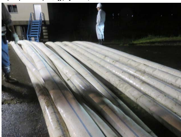
(3) 12本の排水パイプ
