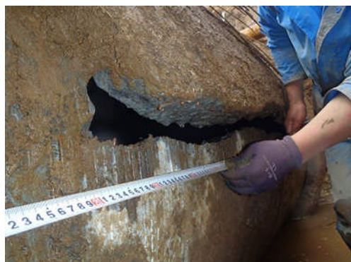
③既設P C管破損状況
