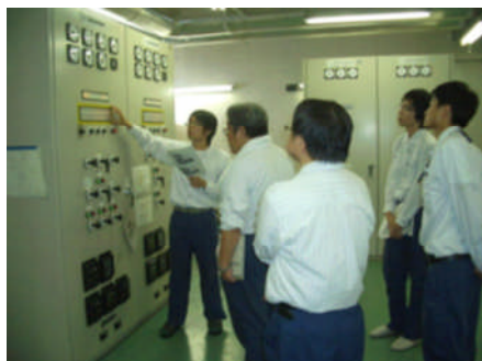
予備発電機起動訓練
