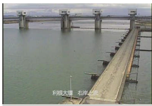
監視画面（大堰上流）
