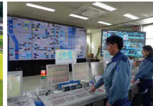
集中管理による適切な用水供給 (利根導水路)
