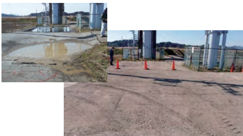
施設周辺の沈下は埋め戻して応急復旧（成田用水施設）
