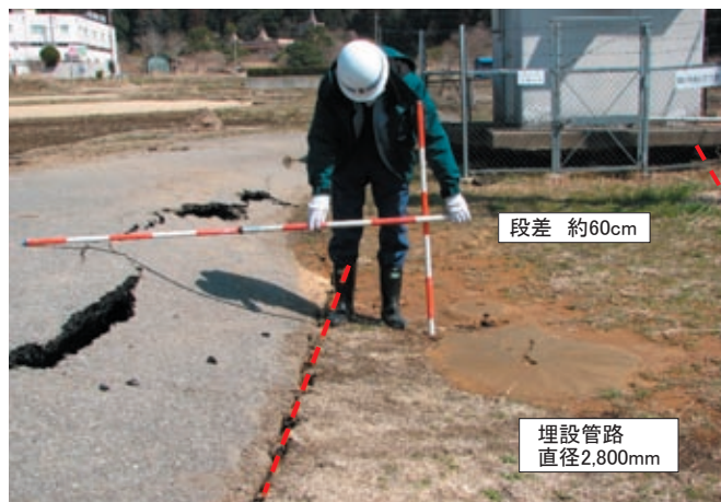
管路上部の沈下
