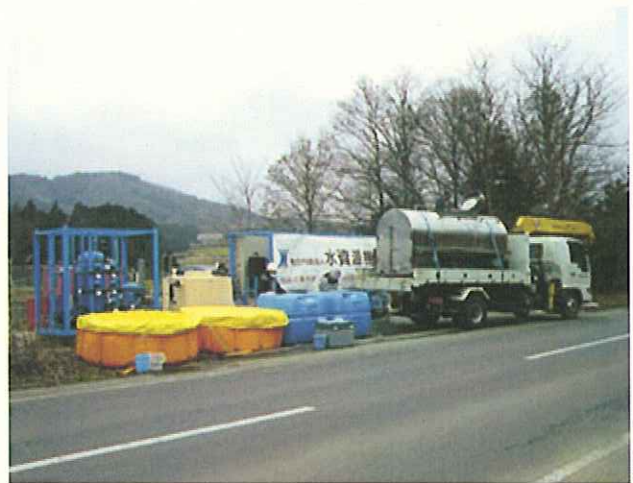
可搬式海水淡水化装置の稼働状況(茨城県桜川市)
