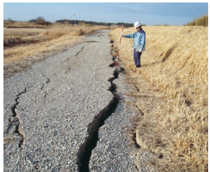
調整池管理用道路に入った亀裂
