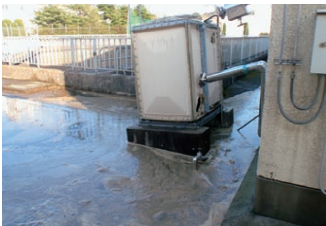
東庄揚水機場周辺の液状化
