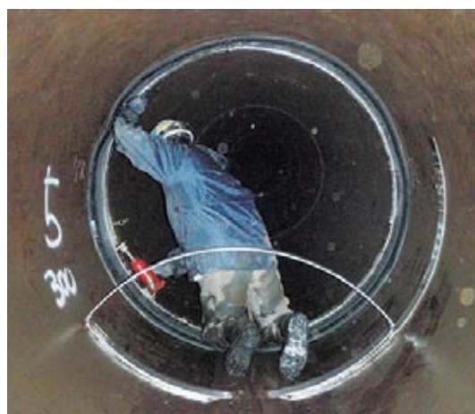
継目補強バンドによる漏水の応急復旧（北総東部用水施設）
