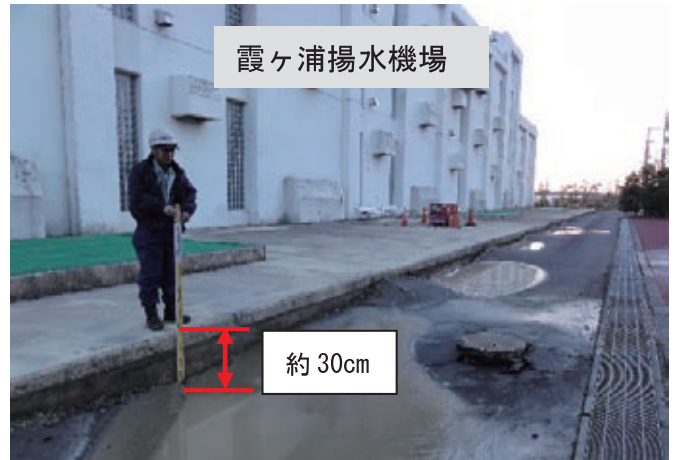
霞ヶ浦揚水機場周辺で発生した沈下
