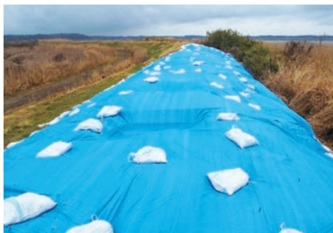
ブルーシートで応急措置した堤防（印旛沼開発施設）
