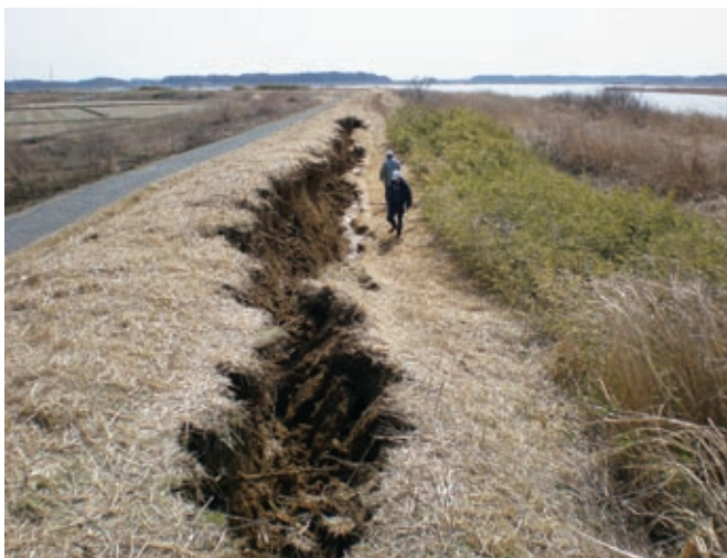
亀裂が生じた調整池堤防
