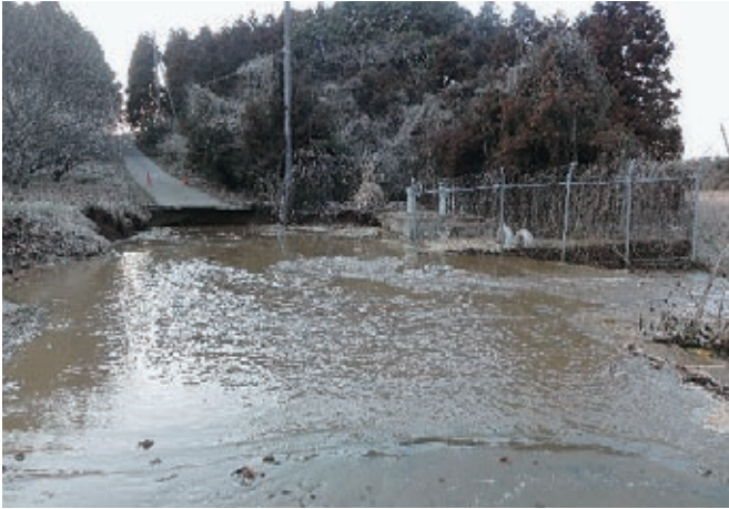
管路の排泥工の破損による地表面への出水 (排泥工：管路内の泥や水を管路外へ排出する設備)
