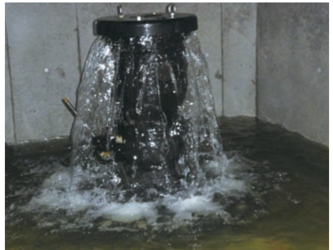
管路に設けられた空気弁の破損による漏水 (空気弁：管路中の空気を自動的に排出する装置)
