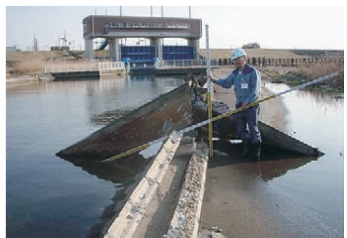
取水口の護岸ブロックの損傷
