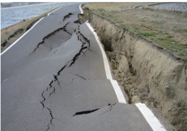
沈下・亀裂が生じた霞ヶ浦の堤防
