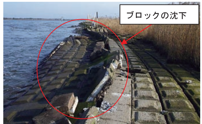
利根川河口堰周辺の護岸ブロックの沈下
