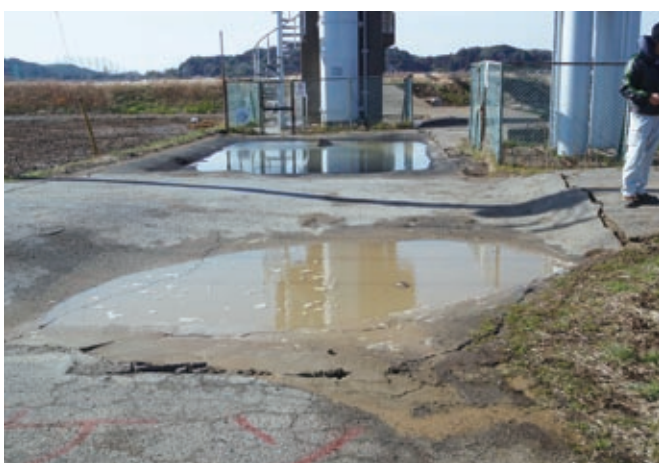
水管橋周辺の沈下
