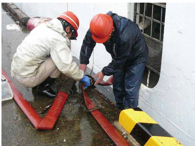
岸壁と船のホースをジョイント
