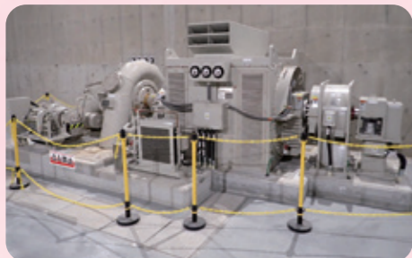
水力発電設備(小石原川ダム)
