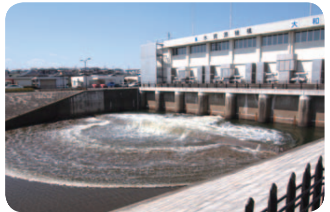
大和田排水機場(放水開始)
