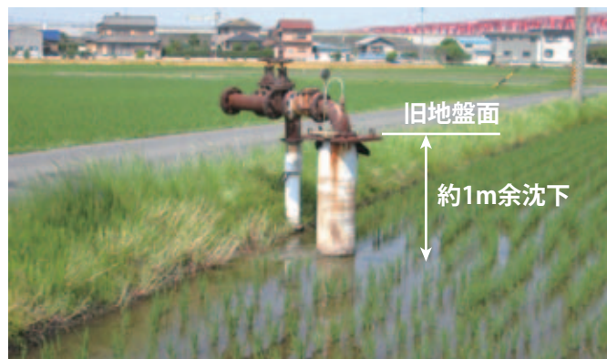
地盤沈下による旧井戸管の抜けあがり状況
