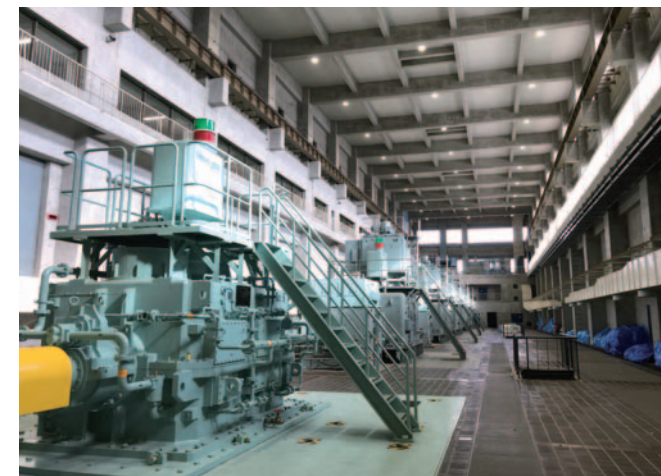
毛馬排水機場内の様子 最大6基のポンプが稼働すれば毎秒330トン(25mプールが2秒でいっぱいになるほど!)の排水能力を誇る
