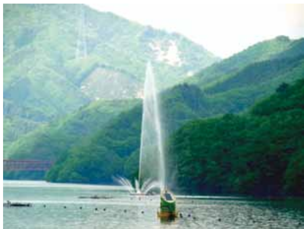
水質自動観測装置（たけのこ）（手前）と噴水合体型散気管式浅層曝気循環設備（奥）
