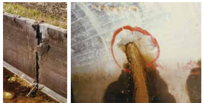
老朽化の状況
