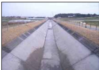
ライニングの変状(クラック)状況
