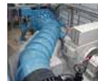
水力発電設備
