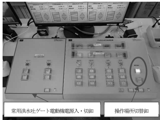
写真-3 ダムコン更新後の操作卓外観(総管)
