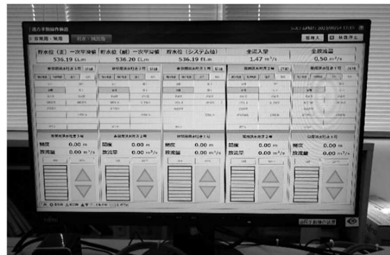
写真-2 ダムコン更新後のモニター外観(総管)
