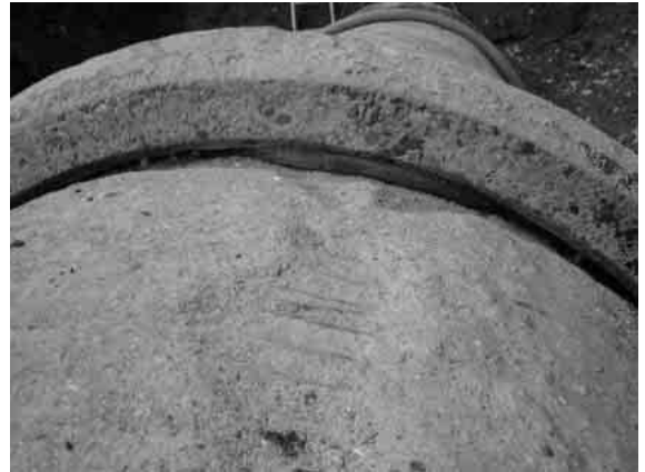
写真-8 継手部の漏水によるカバーコートの洗掘 (木曾川用水 左岸幹線)
