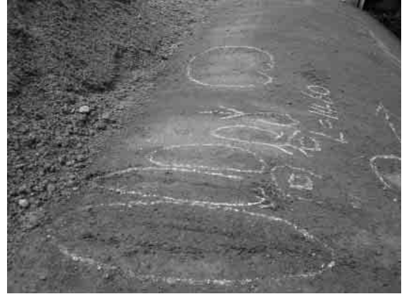
写真-5 上面の劣化状況 (香川用水 高瀬支線)
