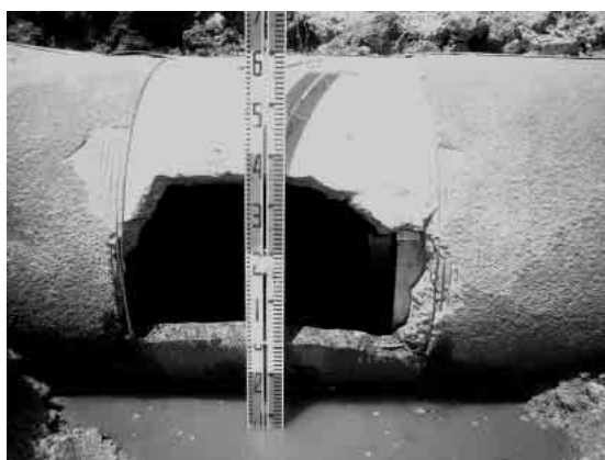
写真-1 PC管本体の破裂事例1（三重用水）
