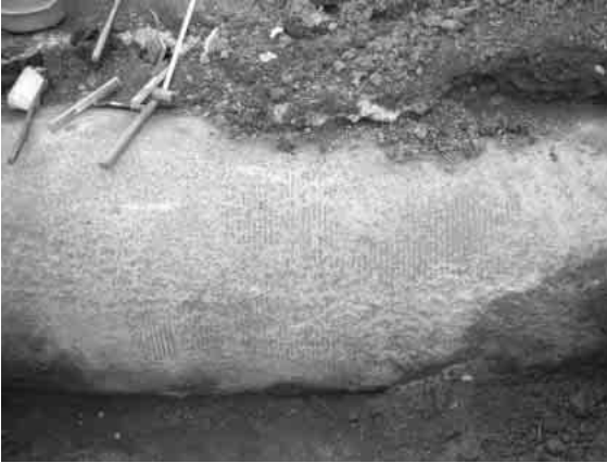
写真-3 側面の劣化状況 (三重用水 竹谷支線)
