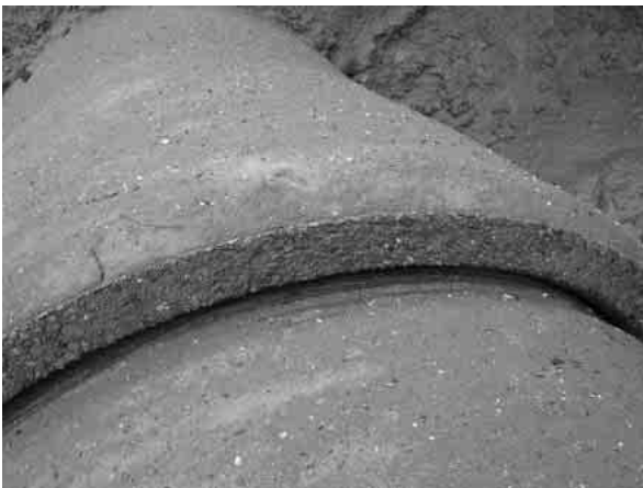
写真-7 継手部（挿口）の劣化状況 (木曾川用水 左岸幹線)
