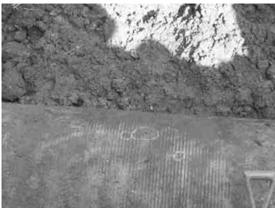
写真-4 上面の劣化状況 (三重用水 竹谷支線)
