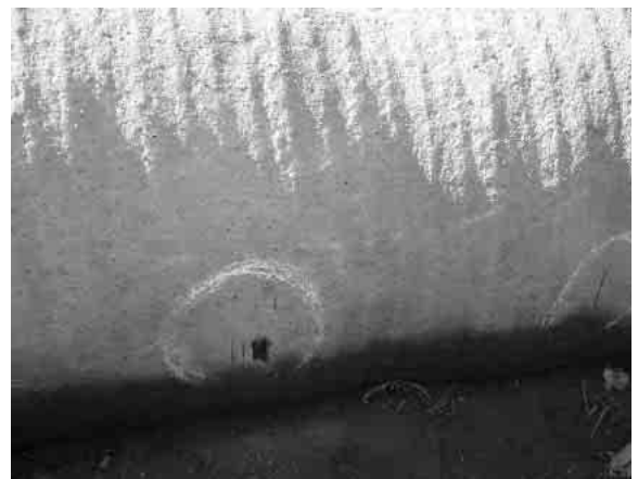
写真-6 部分的な劣化状況 (木曾川用水 左岸幹線)
