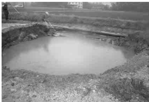
写真-2 破裂事例1（写真-1）による地表面の陥没状況
