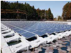
太陽光発電設備と六角フロート （成田用水(高田ファームpond)） ※3
