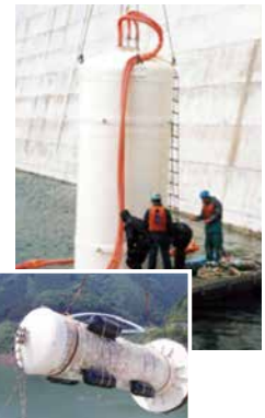
設備の設置状況
