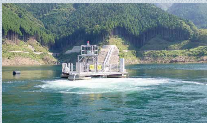
曝気循環設備
