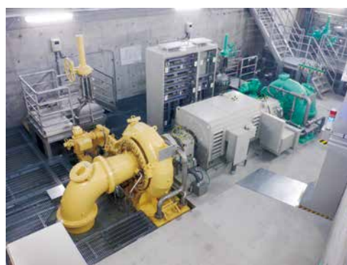
管理用水力発電設備 (川上ダム：令和5年度から稼働)
