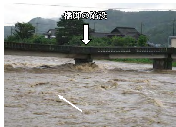
写真 2.3-2 洪水により被害を受けた橋梁
