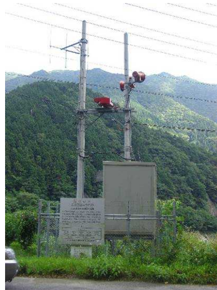
警報設備（他ダム事例）
