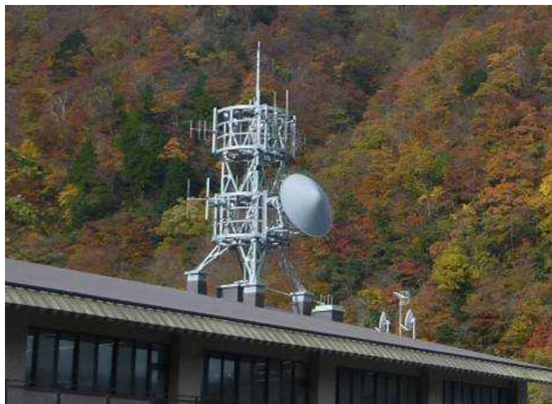
通信設備（他ダム事例）
