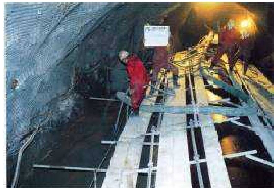
転流工閉塞状況（他ダム事例）
