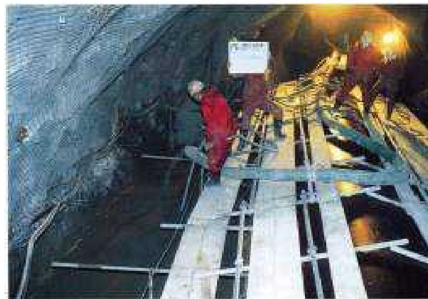
転流工閉塞状況（他ダム事例）
