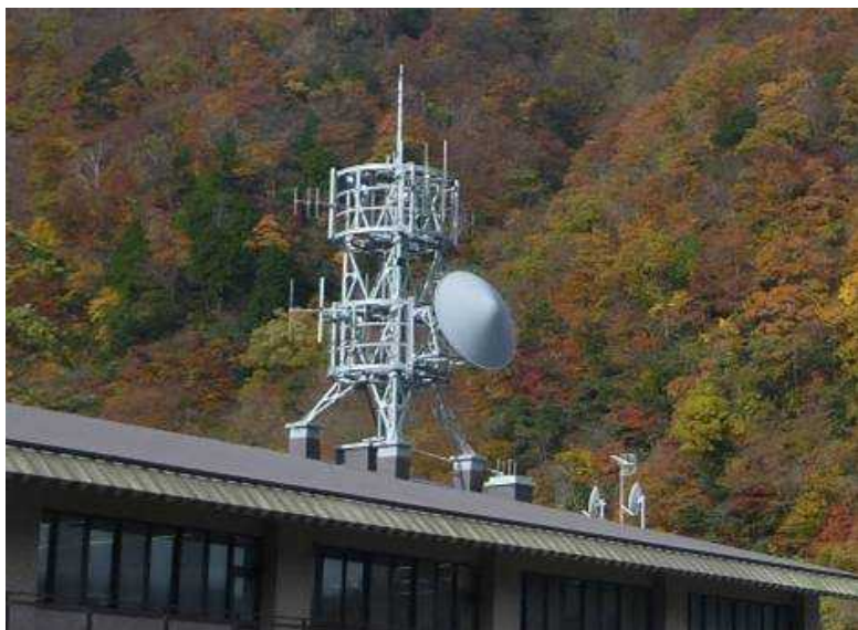
通信設備（他ダム事例）
