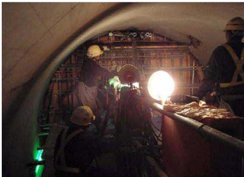
転流工閉塞状況（他ダム事例）
