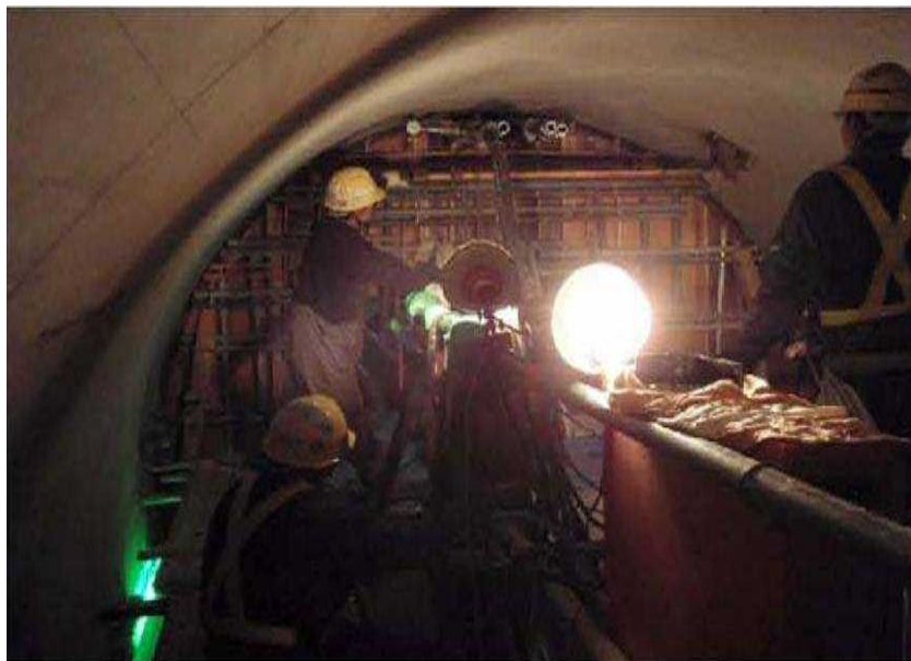
転流工閉塞状況（他ダム事例）
