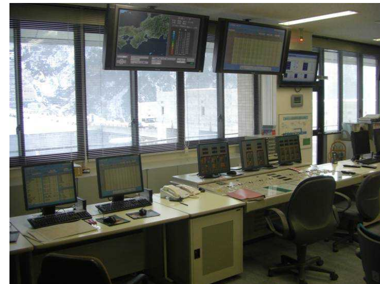
放流制御設備（他ダム事例）
