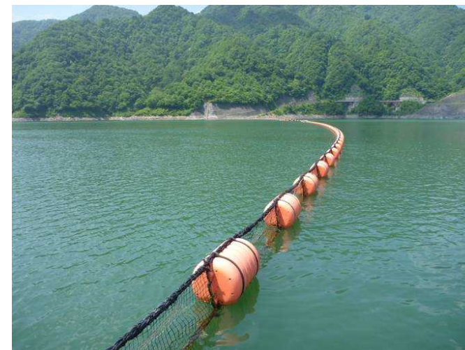
流木止設備（他ダム事例）
