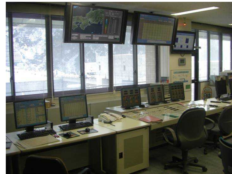
放流制御設備（他ダム事例）
