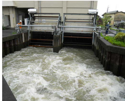
米原排水機場排水ポンプ稼働状況
