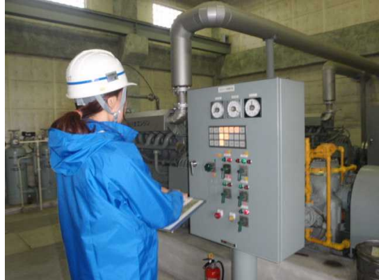
排水ポンプ運転
