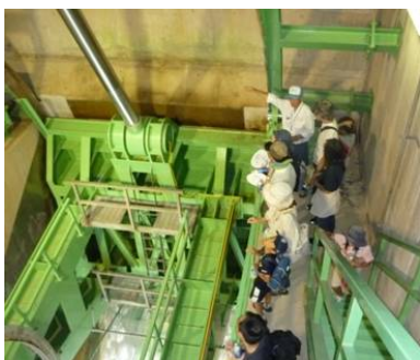
常用洪水吐（コンジットゲート）
