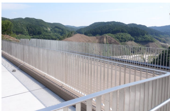
写真 4 ステンレス手摺り
