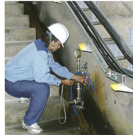
漏水量の観測
