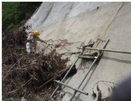
11. モルタル吹付けに水平亀裂が発生し、亀裂部より染み出しが認められる。
