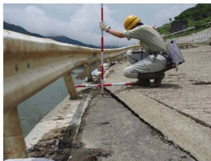
2. コンクリート道路の路壁下部が開口している。
