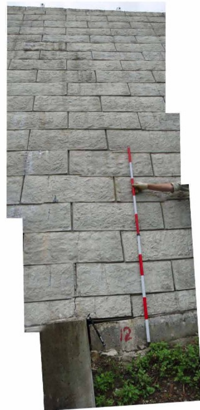
20. テールアルメ擁壁にはヘアクラックが存在し、基礎部の沈下が認められる。
