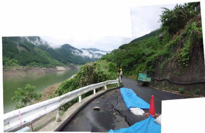
15. 道路は谷側へ沈下し、開口亀裂が存在する。
