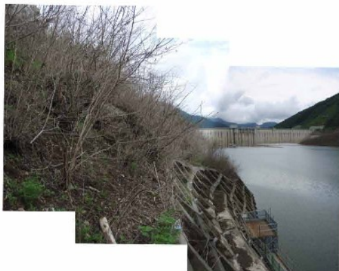
5. アンカー付き法持工の上方斜面には浮石が存在し、周辺は崖錐が被覆している。
