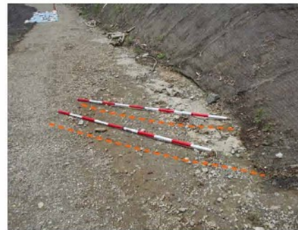
10. 工事用道路に道路を横断するような亀裂が存在する。
