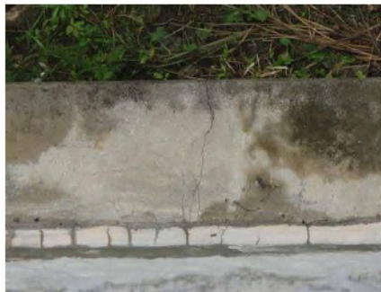
14. テールアルメ擁壁の基礎コンクリート部にヘアクラックが認められる。
