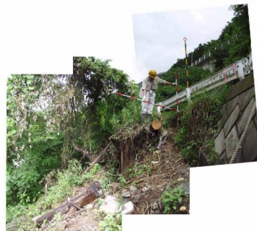
13. 表層が崩壊し、高さが約0.8mの段差地形が形成されている。
