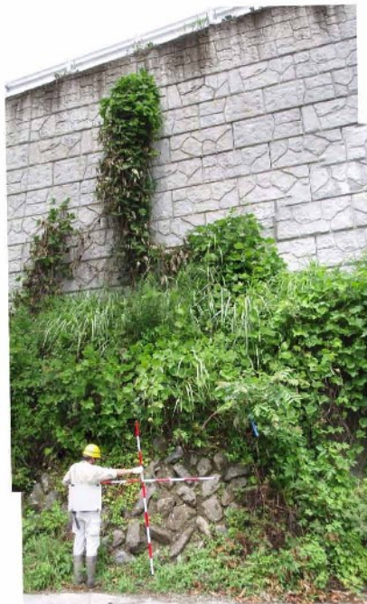
19. テールアルメ擁壁に変状は認められないが、裾部の石積み擁壁には開口亀裂が存在する。
