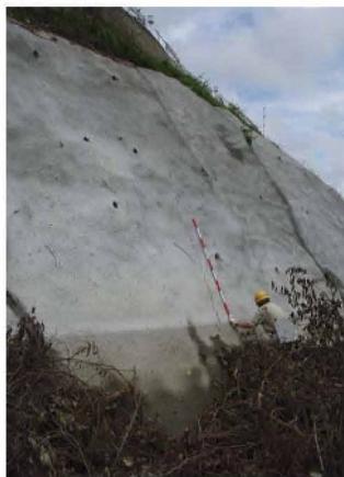
12. モルタル吹付けの縦亀裂は上方斜面際まで伸びている。
