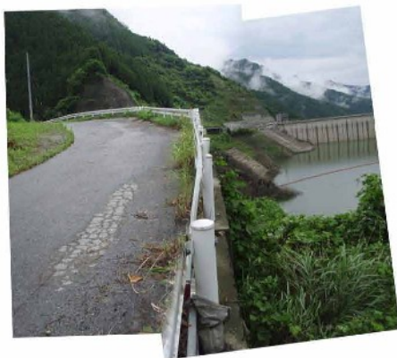
18. 道路の一部が沈下し、擁壁が谷側へ傾倒している。
