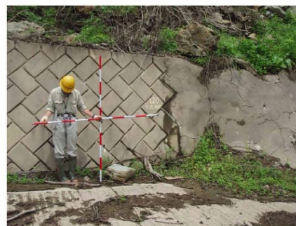
4. コンクリートブロック積み擁壁とモルタル吹付けの境界部が開口している。
