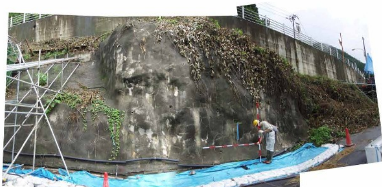
16. モルタル吹付けに多数のヘアクラックと開口亀裂が認められる。
