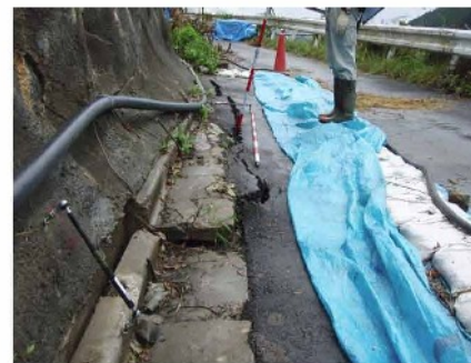
17. モルタル吹付けの裾部の開口亀裂は深さ約30mmである。
