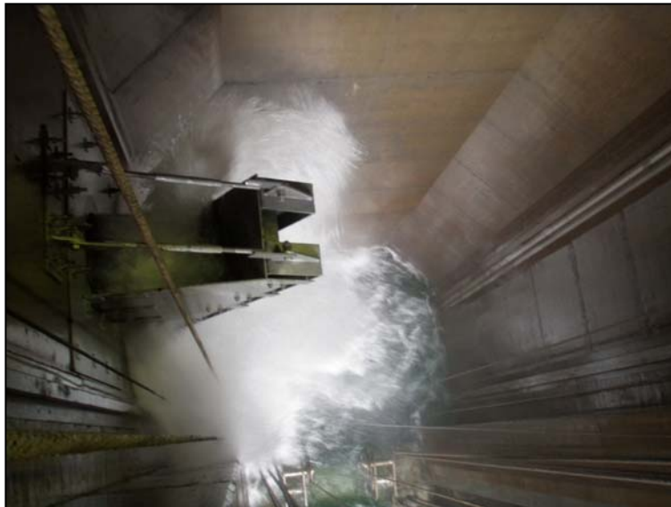
清水バイパス吐出口（取水塔内）
