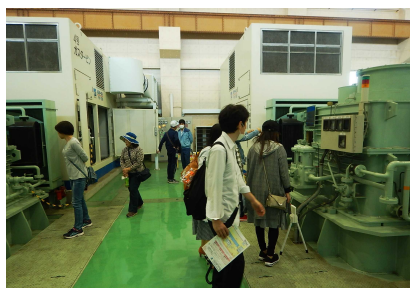
ポンプ設備見学の様子
