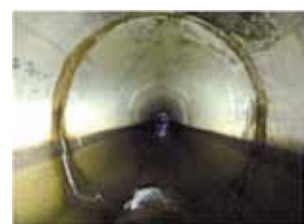
〈トンネルの内部状況（送水停止時）〉 継ぎ目から地下水が吹き出ている。〉
