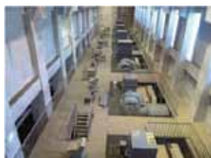
〈老朽化した横芝揚水機場〉
