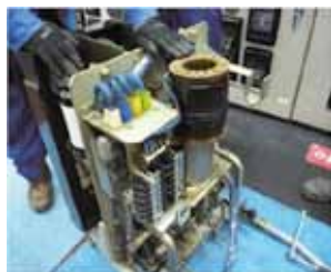
〈電気設備（遮断機）の焼損状況〉
