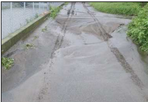
写真 管理用道路の状況:土砂堆積(9/1) (場所:前橋市富士見町)
