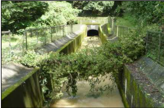
写真 倒木の状況・フェンス破損(9/22)
