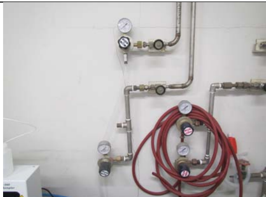
【アルゴンガス供給弁】
