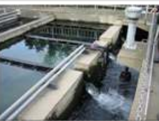
城山第2浄水場(浄水後の水)
