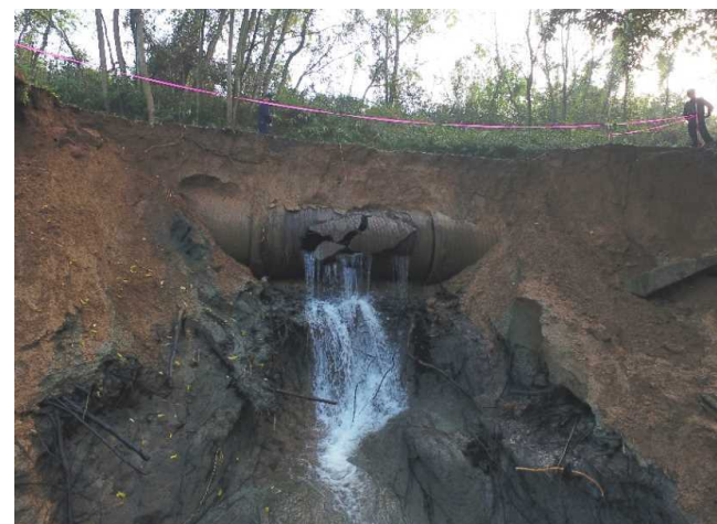
【漏水直後の状況】
