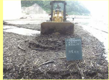
洪水吐きゲート(上流部) 塵芥の集積状況
