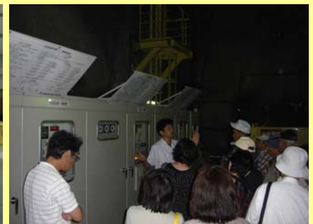
徳山ダム堤体内(ゲート室)
