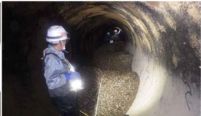
パイプの中の堆積物の状況を確認。調査中に除去も実施。
