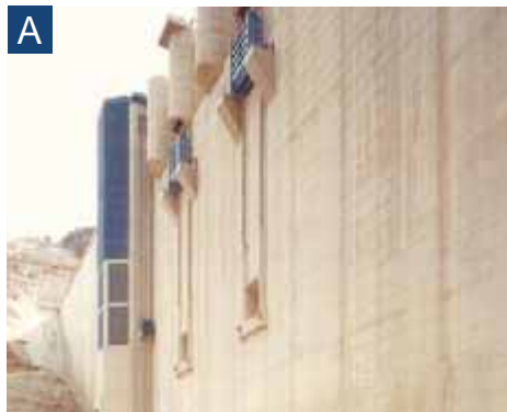
A 表面取水設備 貯水池の表層水を取水する設備です。洪水などで濁水が流入したときにも、表層の水を取水することによって下流に濁りの少ない水を放流することができます。
