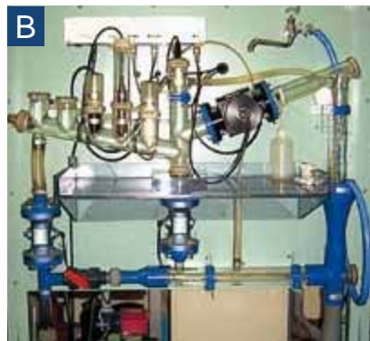
B 水質自動監視装置 ダム流入河川、ダム貯水池、ダム利水放流地点で、水温、pH、濁度、溶存酸素、電気伝導度を毎正時計測しています。
